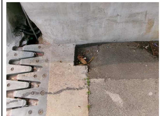
배수시설 S1 배수구 막힘 상태현황
